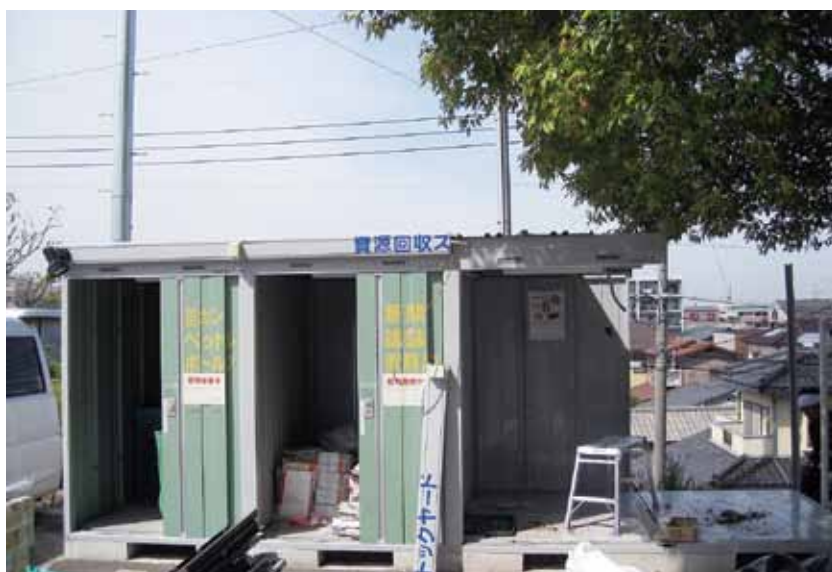
不審火の被害にあったストックヤード
